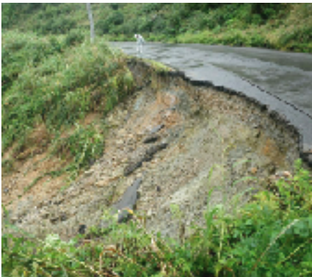
豪雨被害で (災害現場)
