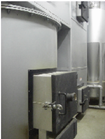
ペレットボイラー
