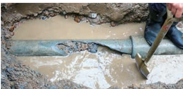
石綿管の布設替が必要
