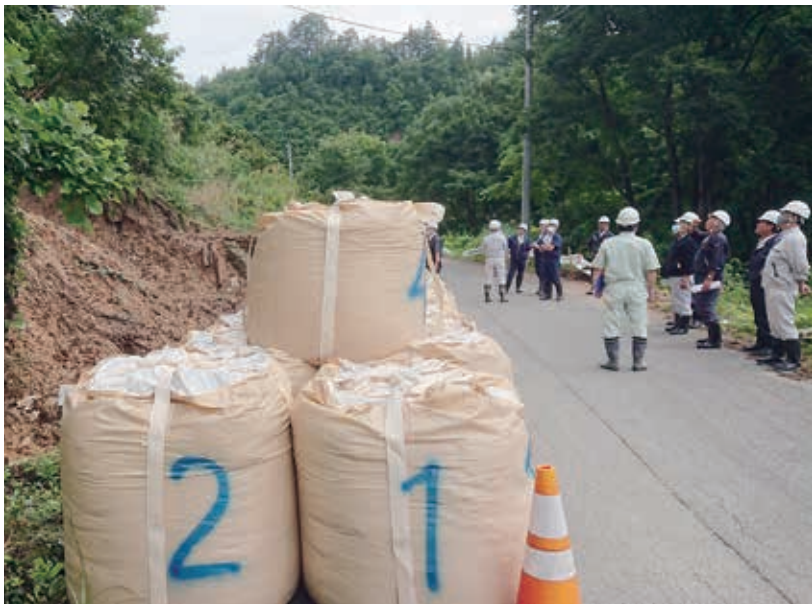
7月豪雨災害による斜面崩落現場（中津川小屋地区）
