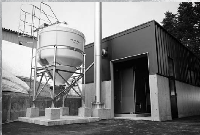
ペレット焚 たき 冷温水機は役場庁舎西側に完成。冷房と暖房の機能を備えているため、年間を通じて木質ペレットを燃料として活用できることに
