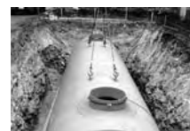
地中に埋設される防火水槽
