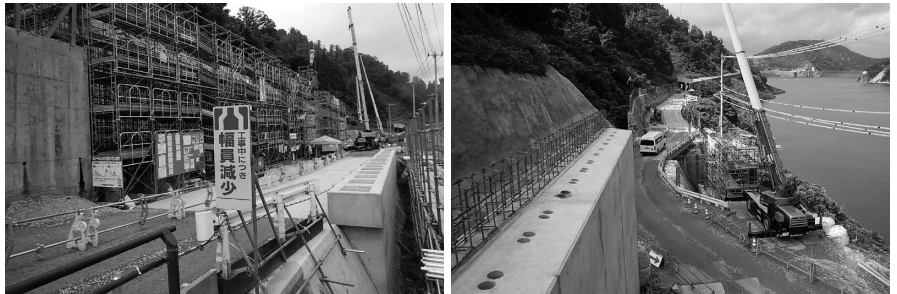
土台コンクリート（完成）と堅壁の施工状況 ダム湖側擁壁の施工状況
